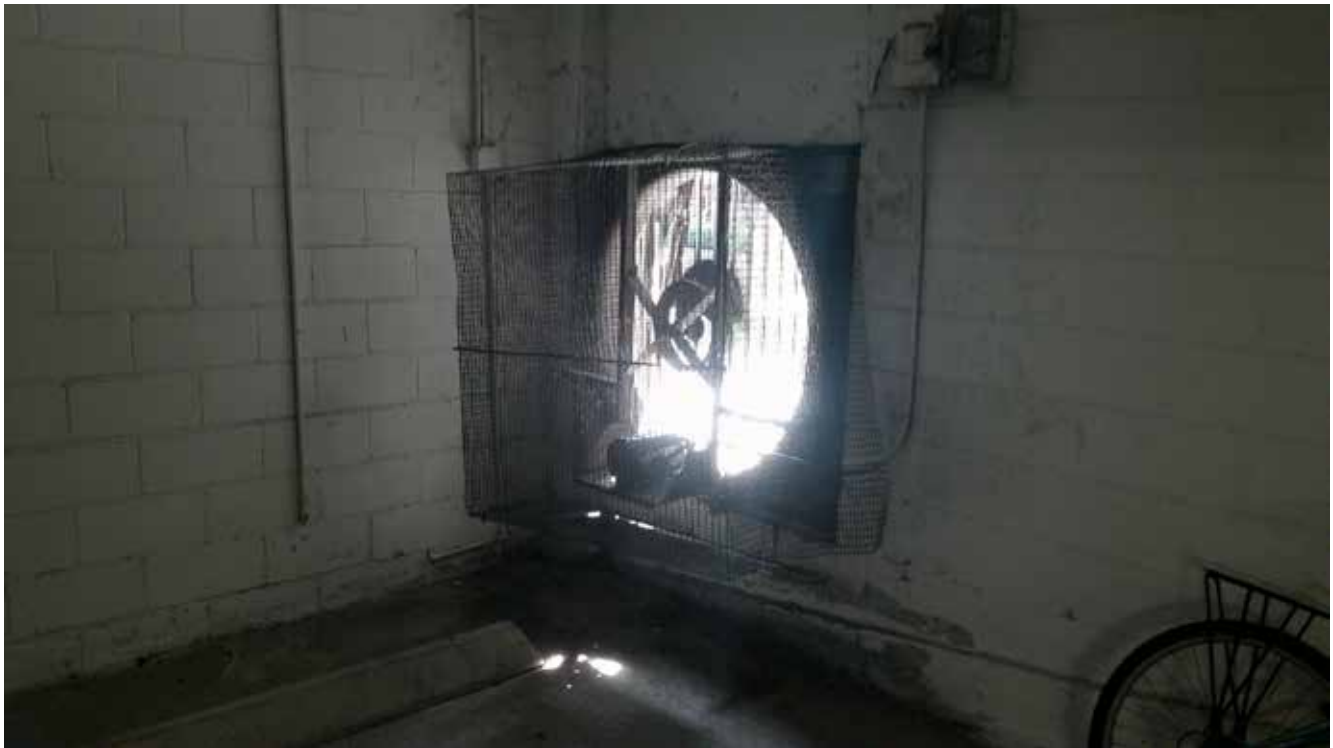
Exhaust Fan - Garage
